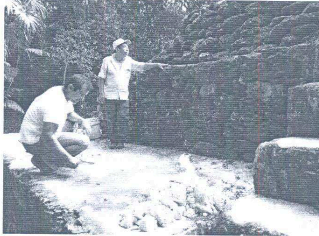
Foto 6. Trabajos de sellado de fisura y reposición de piso de sacrificio efectuados en el Juego de Pelota 1
